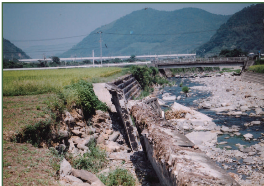
▶ 護岸倒壊事例
